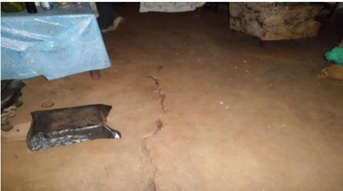
Antes de la reparación del piso.
